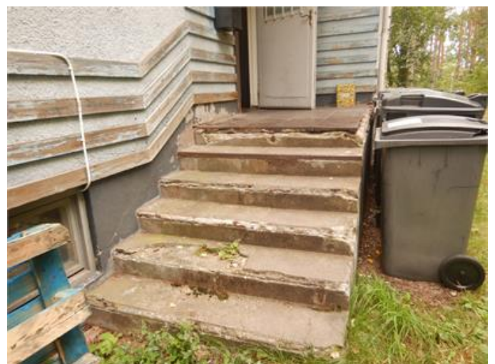
Frysskador på betongtrapp.
