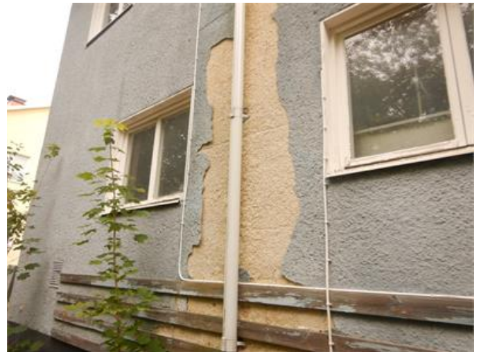
Färgsläpp på fasad.
