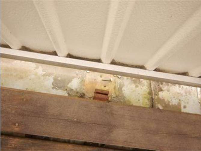
Skruvhål och otätheter i plåttak under trall på balkong.
