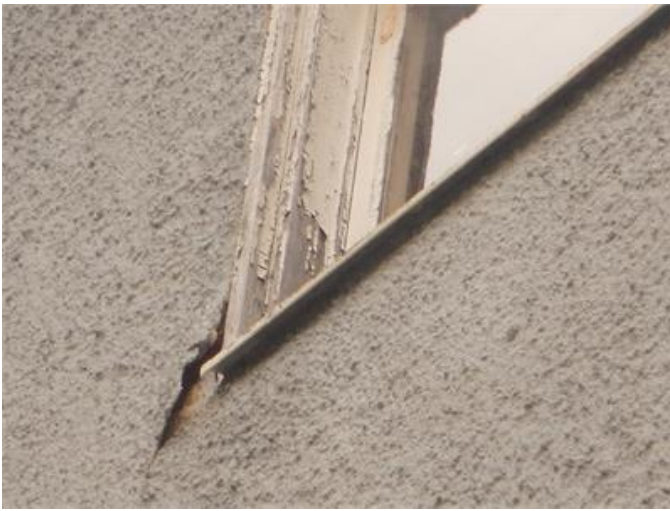
Sprickor i puts omkring fönster.
