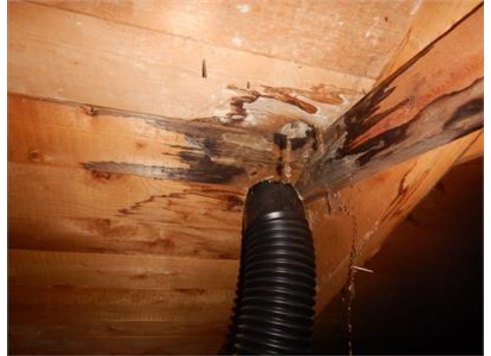
Missfärgning på yttertaketets insida efter tidigare fuktpåverkan.
