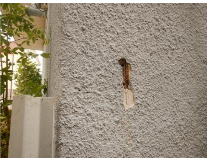
Mindre skador i puts på fasad.
