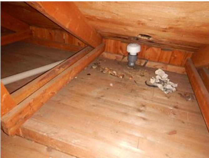
Vacuumventil placerad nära takfot vilket kan orsaka kondens på yttertaketets insida.
