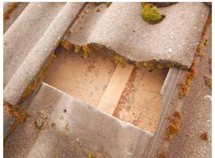
Underlagstak på äldre del med plywood utan tjärpapp.
