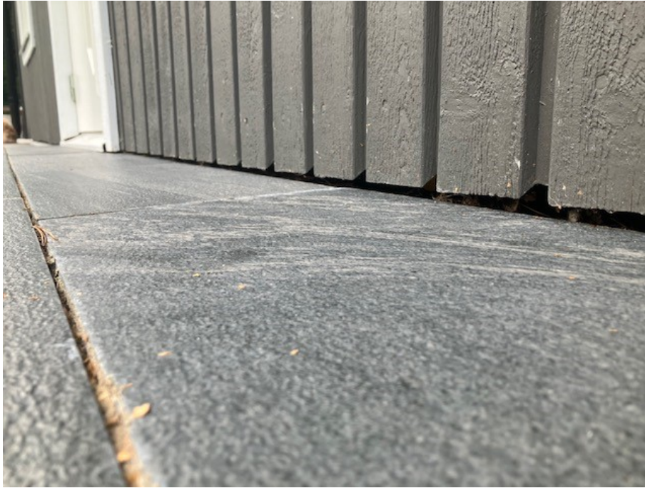
Otättheter mellan fasadpanel och entrétrappa.
