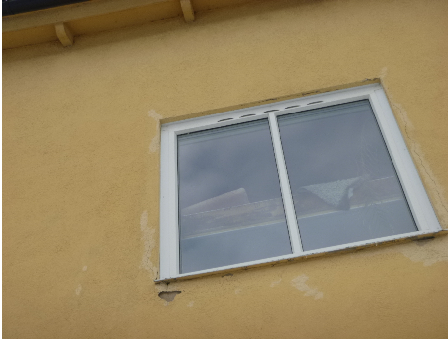
Sprickbildning/putssläpp intill fönster.
