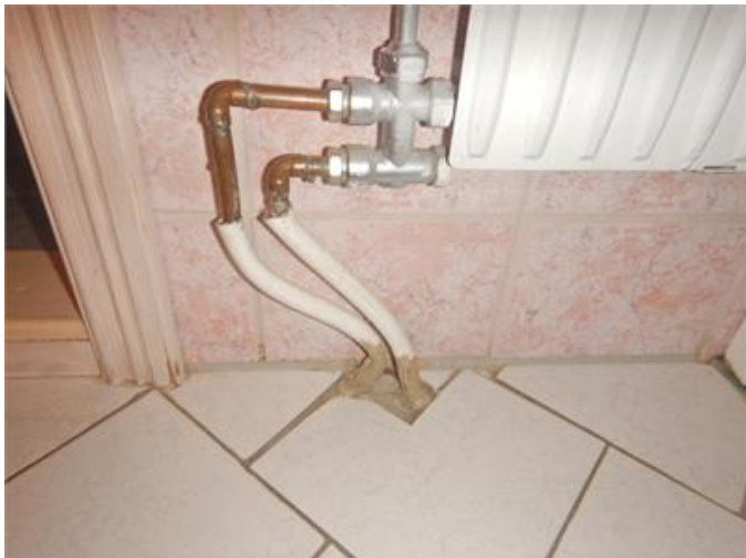
Kraftig böj på radiatorrör.
