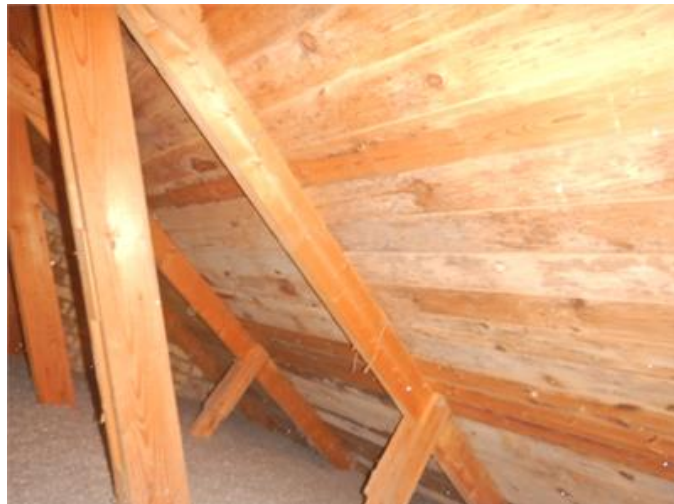
Påväxt på begränsad yta av yttertaketets insida.
