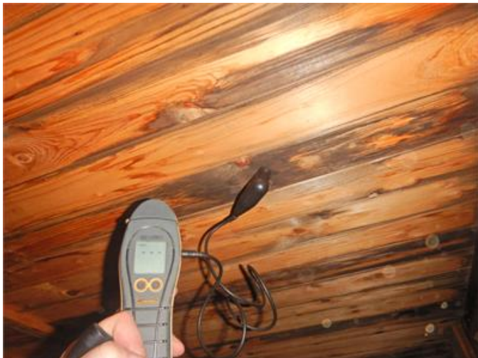
Missfärgning efter tidigare läckage.
